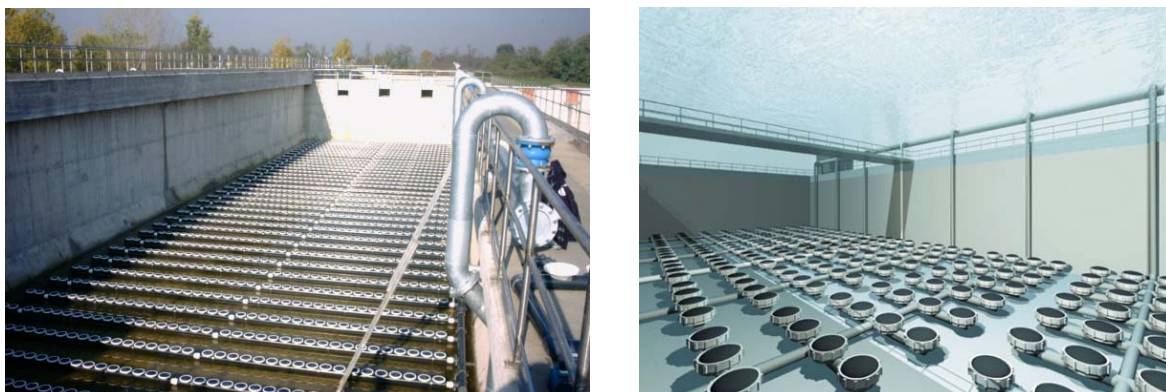
Figura 10 - Esempio di installazione sistema di insufflazione aria a bolle fini
